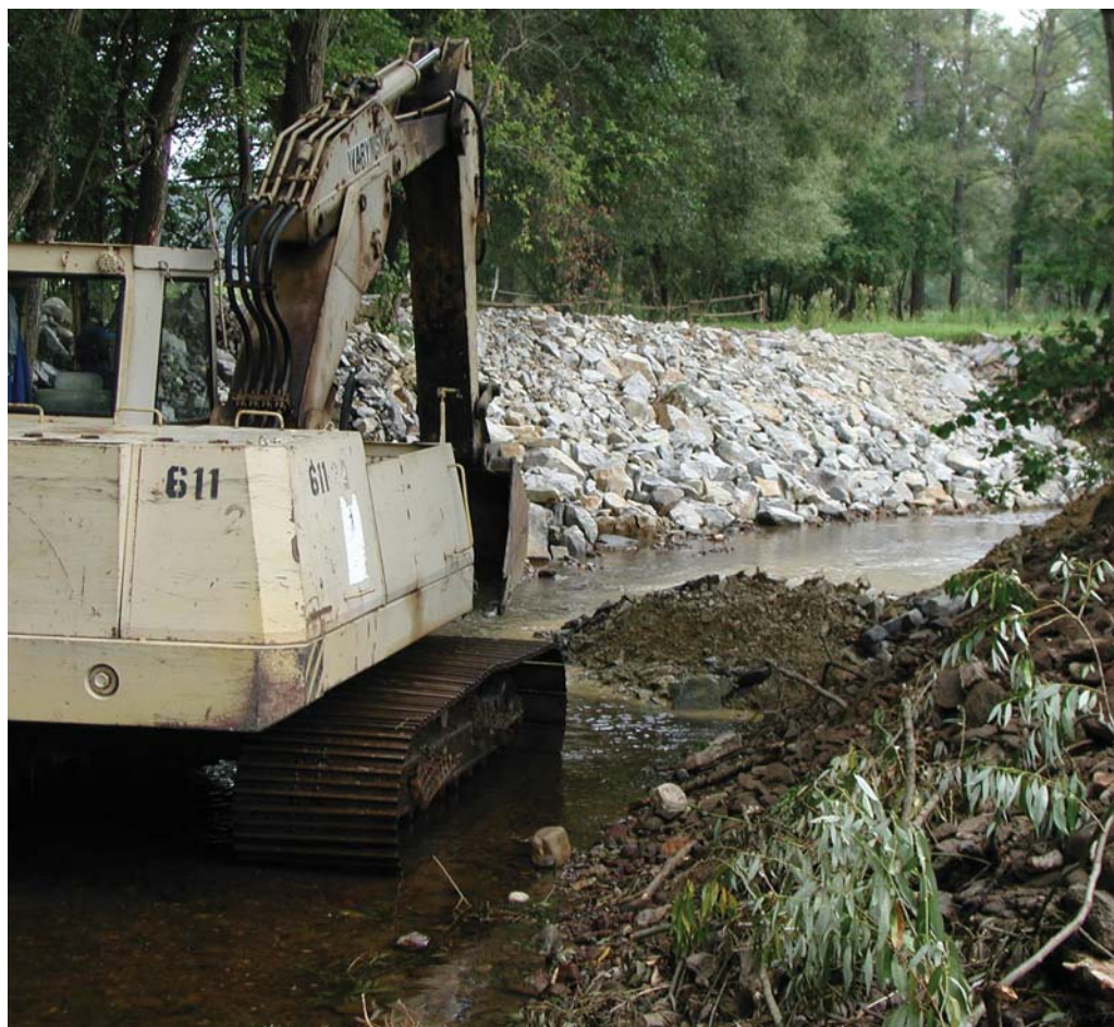
Obr. 4.6.7. Běžný způsob destrukce říčního koryta při tzv. protipovodňových úpravách
