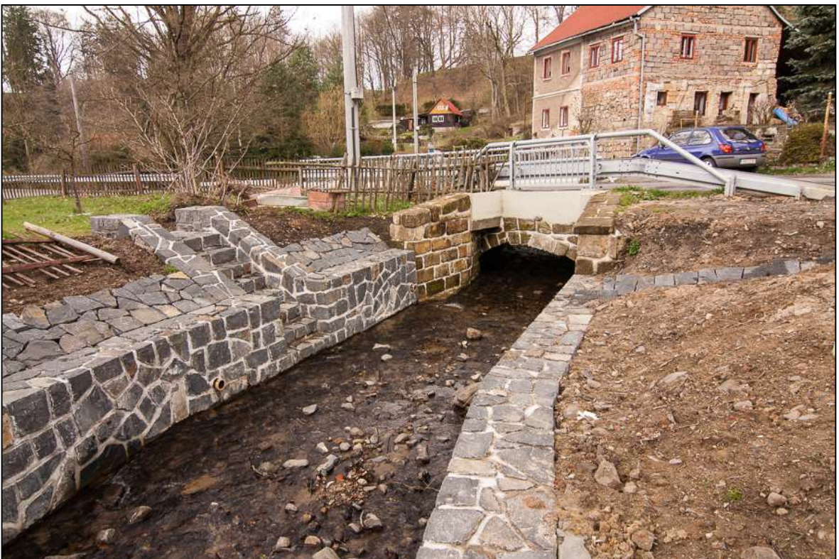
Obrázek 30 Horní úsek toku (v intravilánu) s tvrdým kamenným opevněním dna i břehů. Studený potok – severní Čechy. (foto M. Petrtyl)
