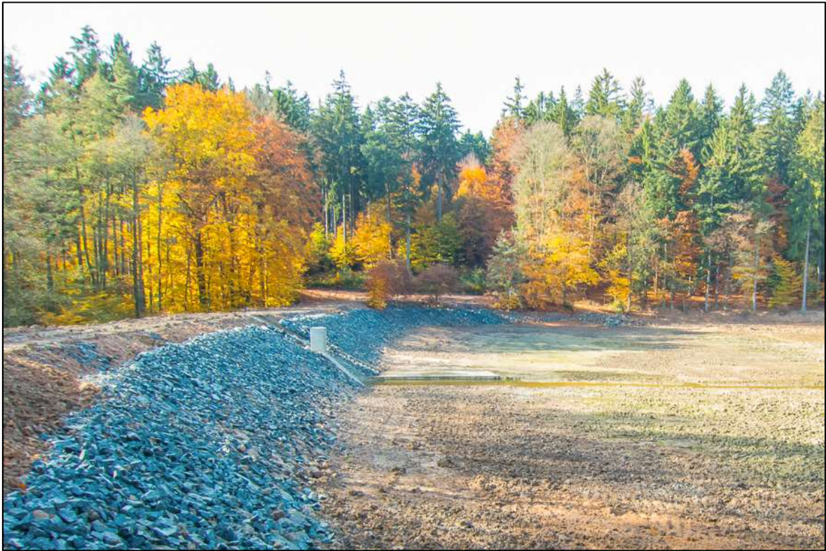
Obrázek 37 Zpevnění tělesa hráze kamenným záhozem u umělé rybochovné nádrže. Rybník Ján – střední Čechy. (foto M. Petrtýl)
